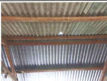
Foto 1: Se pueden observar láminas acanaladas rotas
