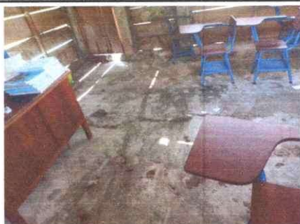
Foto 5: Piso deteriorado de las aulas, necesita sustitución
