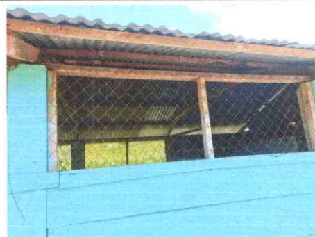
Foto 4: Se observa una de las ventanas de madera que necesita sustitución por balcones de metal
