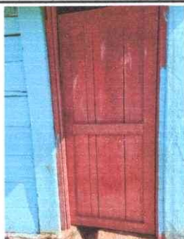
Foto 3: Se observa una de las puertas de madera que necesita sustitución por puerta de metal
