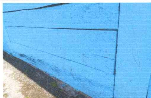
Foto 6: Se observan las paredes de madera, se están pudriendo, por lo que necesita sustitución por paredes de block
